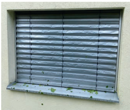
Massive Hagelschäden an Storen
